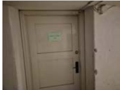
En del rum har inte kunnat kontrolleras i samband med rivningen då dom varit låsta. Dessa rum behöver undersökas innan rivning, bland annat med avseende på asbest i eventuella rörböjar, klaffluckor, skivor, fix och fog, lim eller mattor, mjukgörare i mattor och annat material som kan utgöra farligt avfall eller kräva särskild hantering. Se markering på ritning i bilaga 1.
