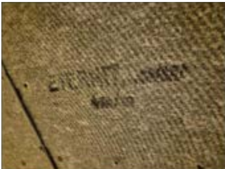
Eternitplattor innehållande asbest har noterats i delar av taket i rum 09015 by 111. Exakt mängd och utbredning är ännu ej kartlagt.
