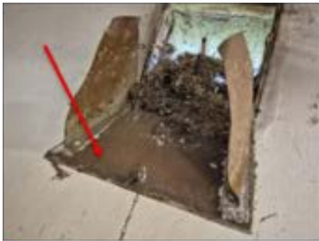
✗ Exempelbild kondenspapp innehållande asbest på insida av klafflucka.
