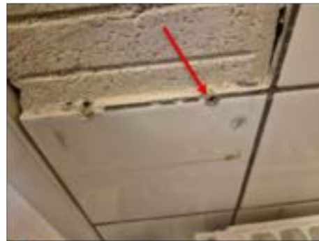
✗ 10045:2. Vegg hål i kakel. Björnplugg. Innehåller asbest.
