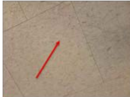
✗ 09024:1. Vinylplastplatta ljusbeige + svartlim. Ej asbest. OBS! Svartlim klassas ändå som asbest, då prov 09003:1 + 09008:1 och 09005:1 påvisat asbest i samma typ av underlag. Vinylplastplatta är farligt avfall avseende klorparaffiner och ftalater.
