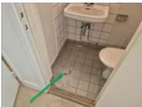
✓ 09006:1. Fix och fog vid gråspräckligt klinker. Ej asbest.
