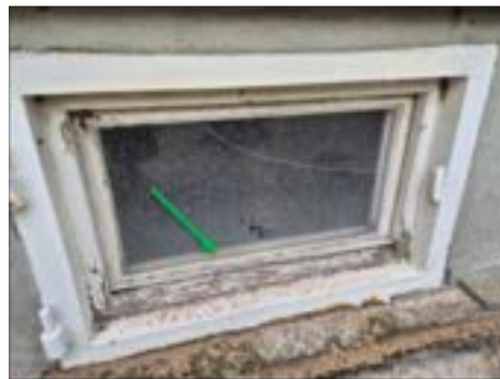
✓ V:4. Fönster. Kitt vitt mjukt/smuligt. Ej asbest.
