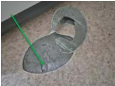
✓ 12028:1. Brunt lim + ytbetong dolt under golvplastmatta med beigtt lim. Ej asbest.
