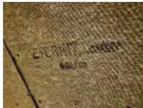
✗ Eternitplattor i tak noterat i by 111. Innehåller asbest.
