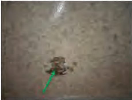
✓ 11031:2 Svartlim under synlig golvplastmatta. Ej asbest.
