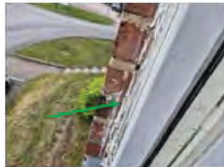
✓ S:3. Vid fönster. Tegel/träkarm. Fog vit fast. Bly halt: 8,54 mg/kg. Ej asbest. Ej PCB. Ej klorparaffiner.
