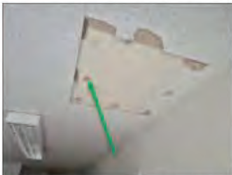
✓ 12002:1. Punktlim under akustikplatta. Lim gulbrunt. Ej asbest.
