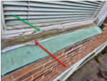
✓ Ö:6 +V:6. Nedan fönster. På träkarm. Kitt ljusgrått sprött. Ej asbest. OBS! kitt nedan fönster vid fönsterkarm och fönsterbleck (röd pil) innehåller asbest. Se prov Ö :7 + V:7.
