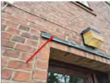
✗ V:1. Ovan droppbleck. Mot tegel. Fog ljusgrå seg/porös. Innehåller asbest. Ej PCB. Ej Klorparaffiner.
