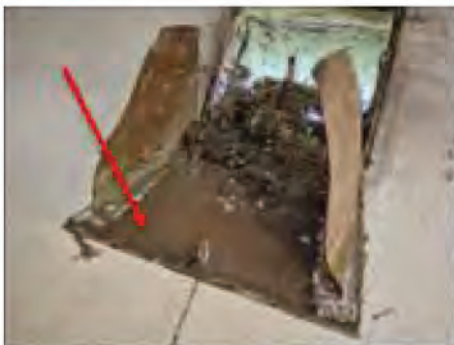
✗ Exempelbild kondenspapp innehållande asbest på insida av klafflucka.
