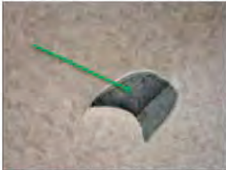
✓ 12003:1+12006:1. Svartlim på betonggolv dolt under ytbetong under golvplastmatta. Ej asbest.
