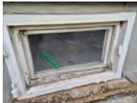
✓ V:4. Fönster. Kitt vitt mjukt/smuligt. Ej asbest.
