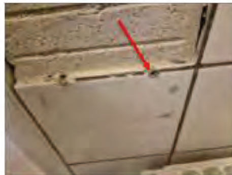
✗ 10045:2. Vegg hål i kakel. Björnplugg. Innehåller asbest.
