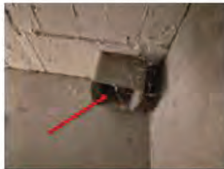
✗ Eternitkanal i tak noterad i by 112 plan 09. Innehåller asbest.
