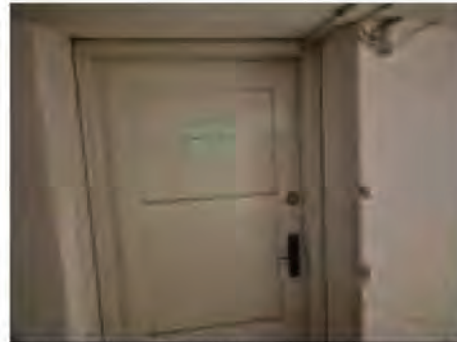
En del rum har inte kunnat kontrolleras i samband med rivningen då dom varit låsta. Dessa rum behöver undersökas innan rivning, bland annat med avseende på asbest i eventuella rörböjor, klaffluckor, skivor, fix och fog, lim eller mattor, mjukgörare i mattor och annat material som kan utgöra farligt avfall eller kräva särskild hantering. Se markering på ritning i bilaga 1.
