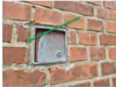
✓ V:8. Runt lucka. Tegel/plåt. Fog grå mjuk. Bly halt: 8,52 mg/kg. Ej asbest. Ej PCB. Ej klorparaffiner.
