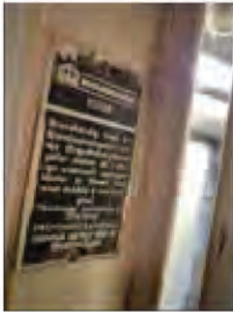
✗ Exempelbild branddörr med risk för innehåll av asbest
