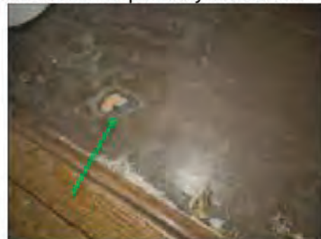
✓ 11025:1 Garderob. Golvmatta brun på väv + underlagspapp med lim. Ej asbest.
