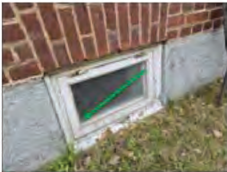
✓ N:4 + Ö:8. Fönster. Kitt vitt fast. Ej asbest.
