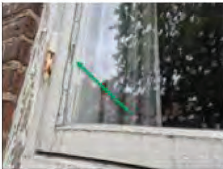
✓ V:3. Fönster. Kitt vitt hårt. Ej asbest.
