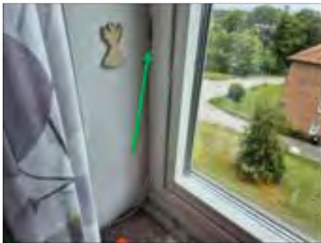
✓ 12027:1. Runt fönsterparti. Fönstersmyg/träkarm. Fog vit mjuk elastisk. Bly halt: 270 mg/kg. Ej asbest. Ej PCB. Ej klorparaffiner.
