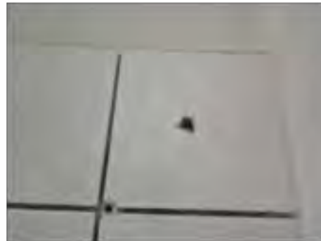
Ev förekomst av ytterligare björnplugg innehållande asbest behöver utredas vidare och kartläggas innan rivning. Samtliga björnpluggar antas innehålla asbest och hanteras separat om inte ytterligare provtagning visar annat.
