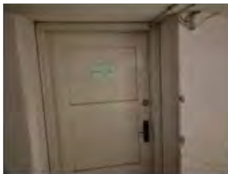
En del rum har inte kunnat kontrolleras i samband med rivningen då dom varit låsta. Dessa rum behöver undersökas innan rivning, bland annat med avseende på asbest i eventuella rörböjar, klaffluckor, skivor, fix och fog, lim eller mattor, mjukgörare i mattor och annat material som kan utgöra farligt avfall eller kräva särskild hantering. Se markering på ritning i bilaga 1.
