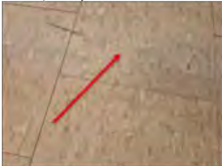
✗ 09003:1 + 09008:1. Vinylplastplatta mörkbeige + svartlim. OBS! Underliggande svartlim innehåller asbest. Vinylplastplatta är farligt avfall avseende klorparaffiner och ftalater.
