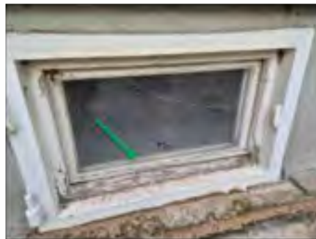
✓ V:4. Fönster. Kitt vitt mjukt/smuligt. Ej asbest.
