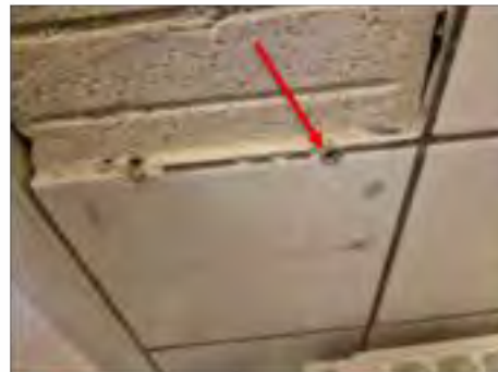
✗ 10045:2. Vägg hål i kakel. Björnplugg. Innehåller asbest.
