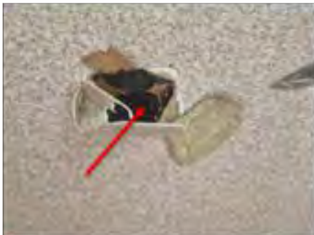
✗ 12012:1. Under brunprickig ljus golvplastmatta. Brunstrimmig golvplastmatta+svartlim. Innehåller asbest
