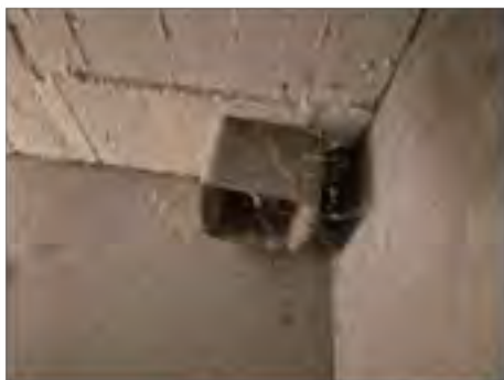
Förekomst av eternitkanaler innehållande asbest behöver utredas närmare då detta noterats i källaren i byggnad 112.
